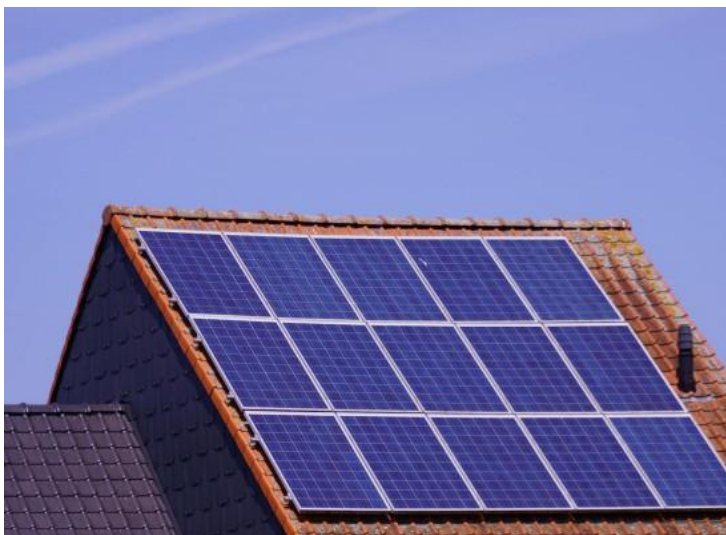
Obraz 15. Instalacja fotowoltaiczna
